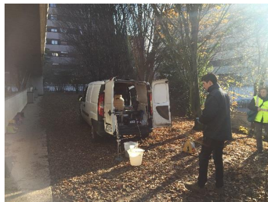
Spurgo del piezometro MW3
