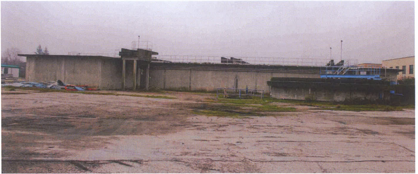
Depuratore vista d'insieme lato ovest (4)
